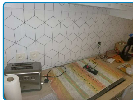
Anomalie B.3.3.6 a2 sur Install. n°1
