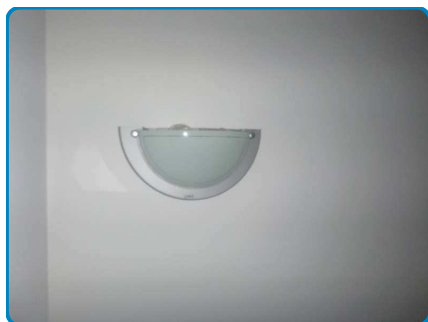
Anomalie B.3.3.6 a3 sur Install. n°1
